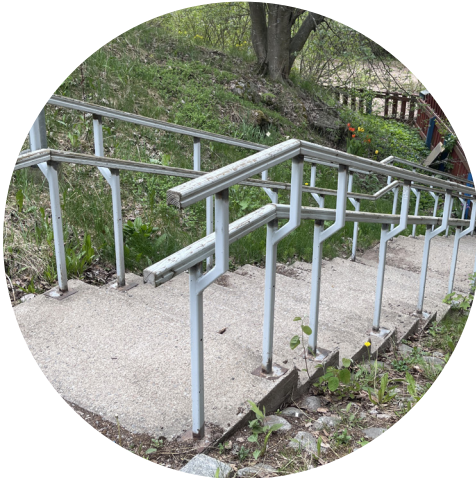
kunnostettava betoniporras ja käsijohde
